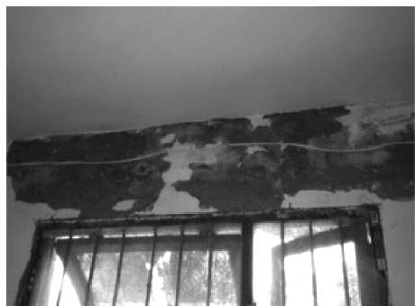
图 12 楼板和砖墙交界处的裂缝、附属物脱落
