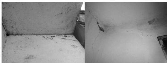
图 11 应力集中部位裂缝形态图
